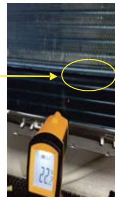
Medición del circuito del refrigerante superior
